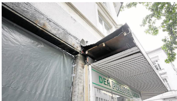
Die Dachvorbauten erhielten die Ladenlokale in den 1970er-Jahren. Um den Blick auf die Fassade wieder frei zu geben, werden sie entfernt. FOTOS: (B); DRAWE
