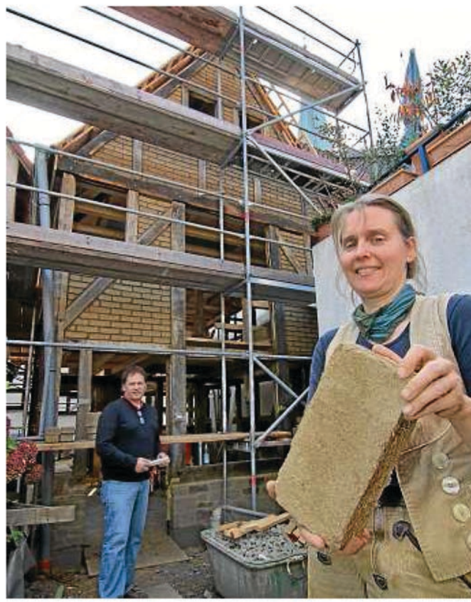
Lehmbauerin Uta Görler füllt die Gefache des alten Hauses mit Lehm. Architekt Ulrich Bräckelmann ist zufrieden mit den Fortschritten auf der Baustelle. Foto: Hennes
