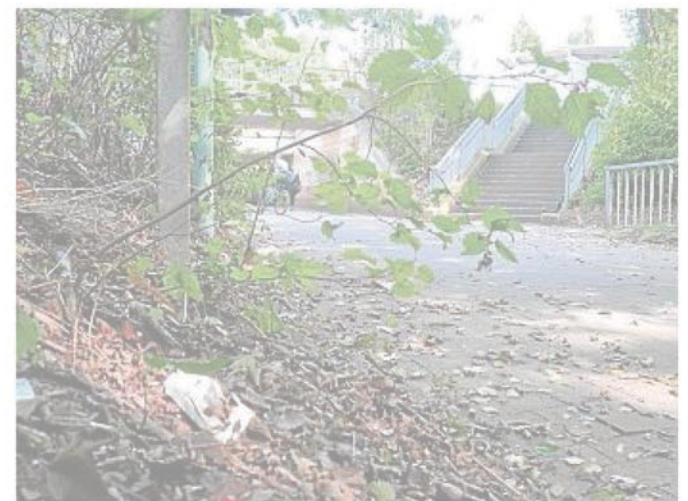
Die Unterführungen am Bahnhof Königsborn wecken bei manchen Passanten ein mulmiges Gefühl, weil Dreck, Graffiti und Spritzen die Anlage wenig ansehnlich machen. Foto: Pieper
